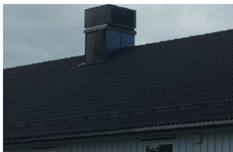
Da flere av platene på «pipa» på gjestehuset ble tatt av vinden i august kom noen av pengene fra Jubileumsgaven til Strand godt med.
